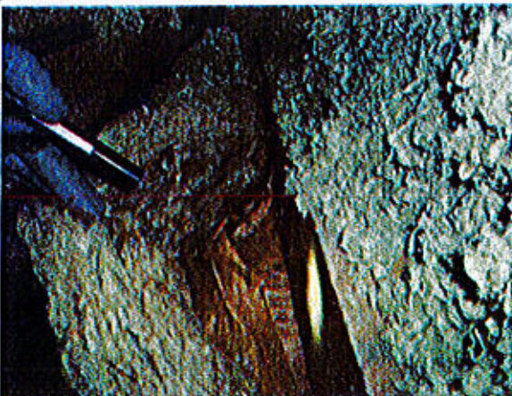
Yläpohjan villoituksissa oli havaittavissa paikallisia värimuutoksia.
